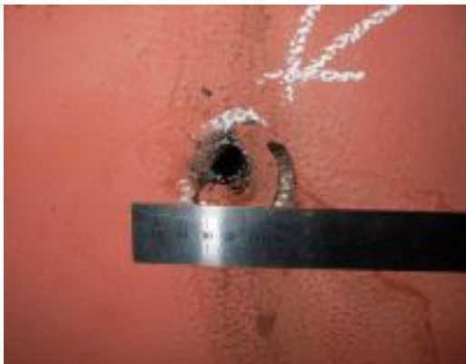
Fig. 1 ビルジタンク船底破口（約 1 cm）
