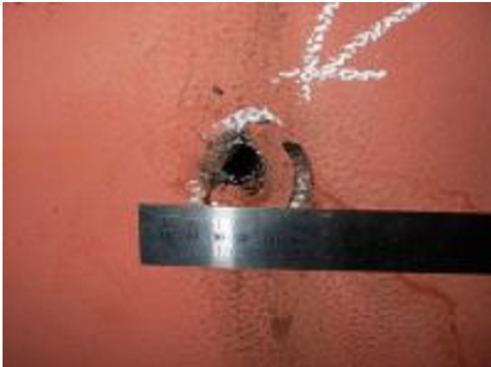
Fig. 1 ビルジタンク船底破口（約1 cm）
